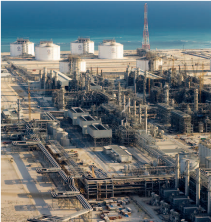
In reihenweise angeordneten Anlagen (Trains) wird Erdgas verflüssigt. Train 4 von Qatargas 2, einem Joint Venture zwischen Qatar Petroleum und ExxonMobil in Katar, dient auch der Versorgung von Europa.
