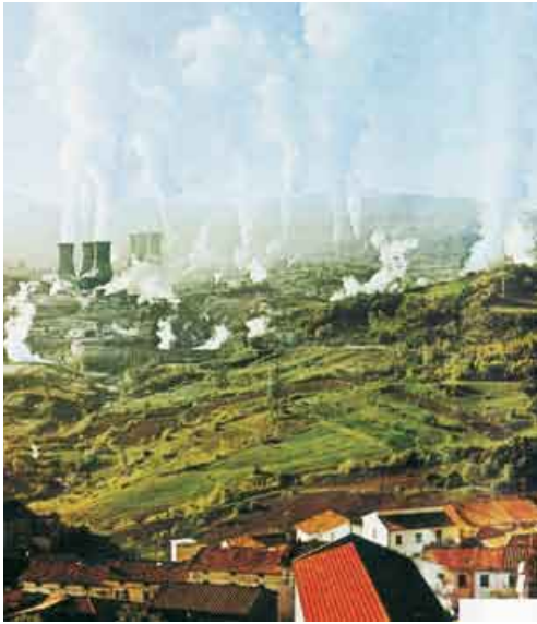
M 3.9 Europas größtes Geothermie-Kraftwerk in Larderello (Toskana)
