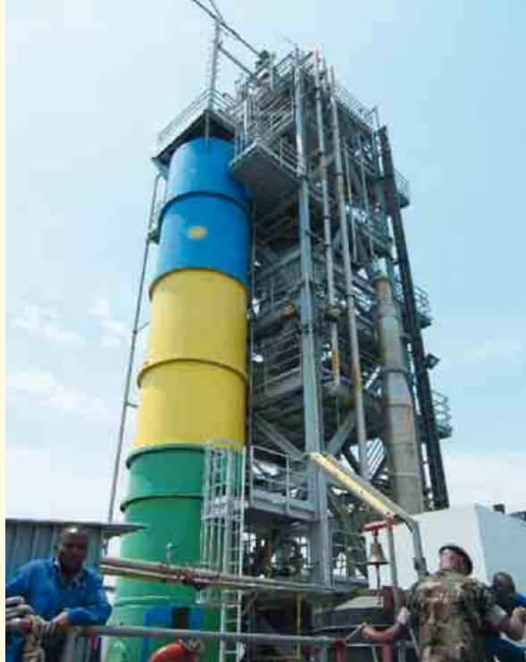
Abb. 2: Methangasförderanlage im Kivusee
